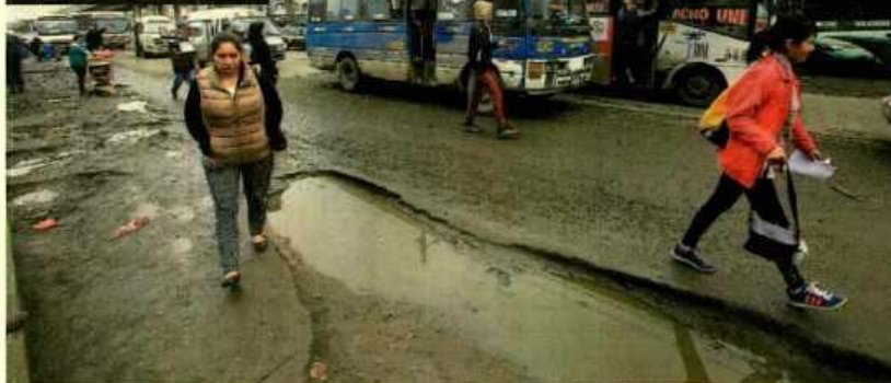
Este es el deterioro y desorden que hoy encontrarían los participantes de Lima 2019 en la Av. de los Héroes, una de las rutas hacia las sedes deportivas.
